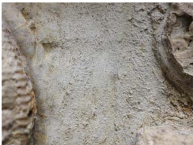
FIG. 228 Aspect du mortier de ciment de 1978.
