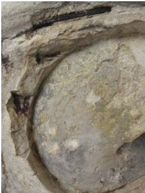
FIG. 426 Armatures métalliques apparentes avant retouche.
