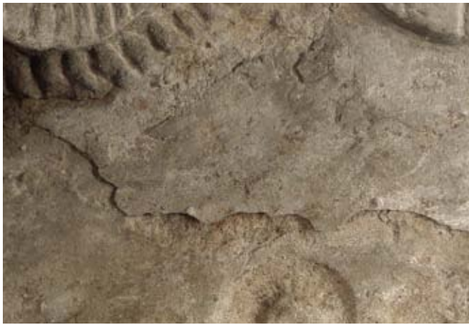
FIG. 252 Soulèvement du mortier de ciment en forme de cloche.
