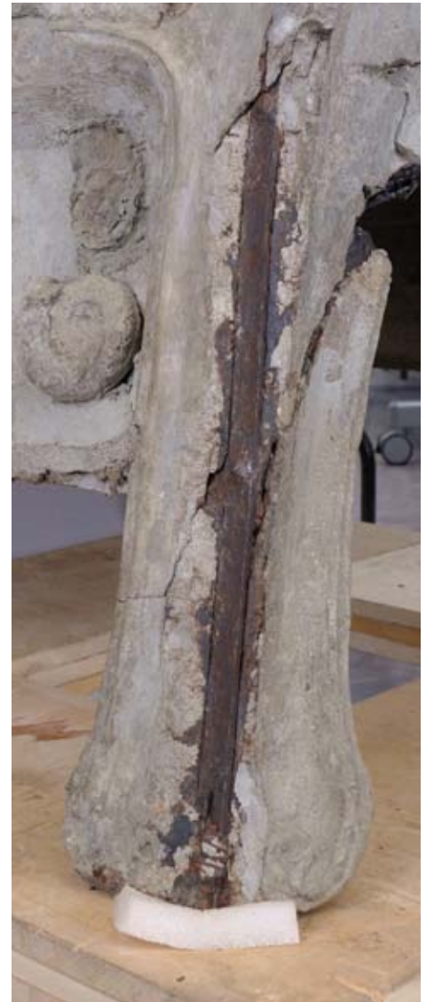
FIG. 372 Armature du pied arrière gauche après traitement.
