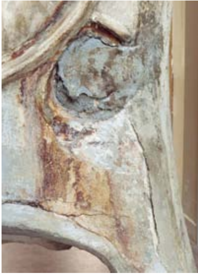
FIG. 373 Coulure de rouille à l'aplomb de F2.
