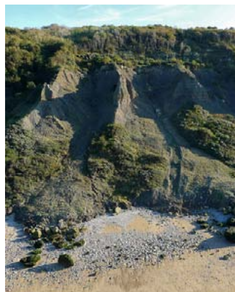
FIG. 265 Affaissement des couches marneuses sous formes de larges coulées.
