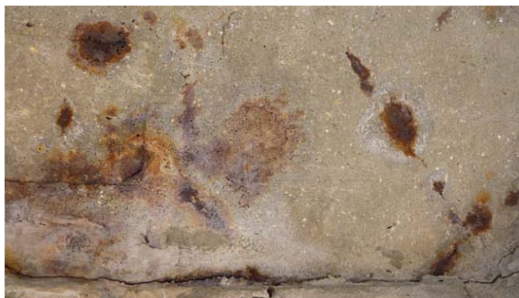
FIG. 249 Diffusion de la corrosion le long des armatures et efflorescences de sels (dessous de l'assise).
