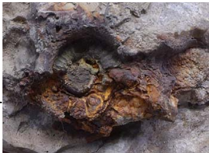
FIG. 279 Dégradation avancée visible dans la partie basse de G2.
