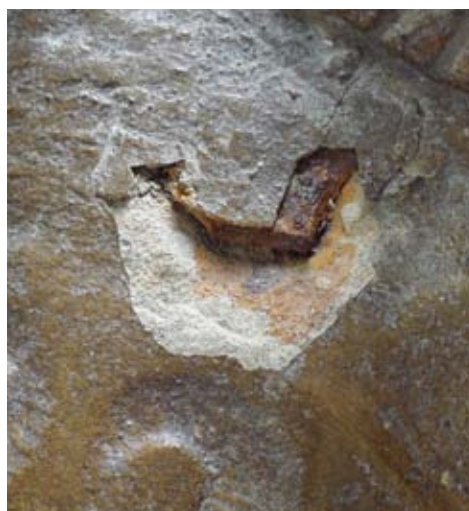
FIG. 247 Patte métallique corrodée ayant entraîné l'éclatement du ciment.
