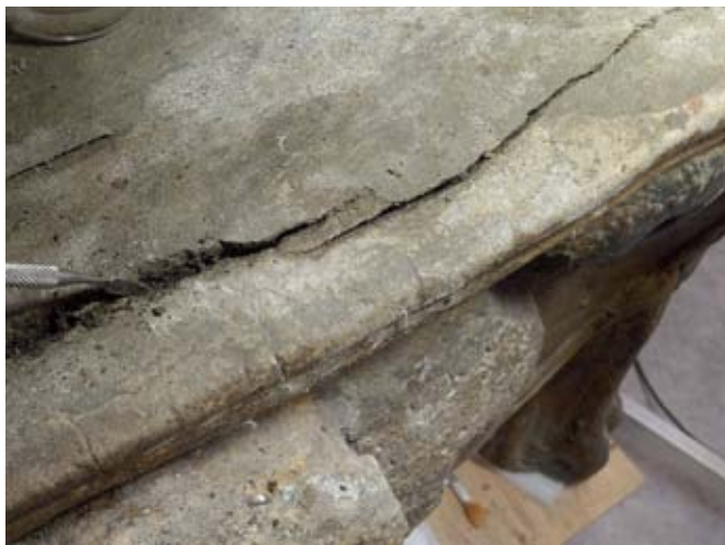
FIG. 254 Fissures se formant à la jonction des coffrages (bord avant de l'assise).
